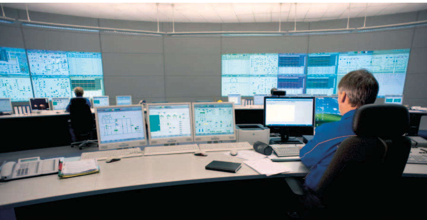
Leitzentrale im Kraftwerk
