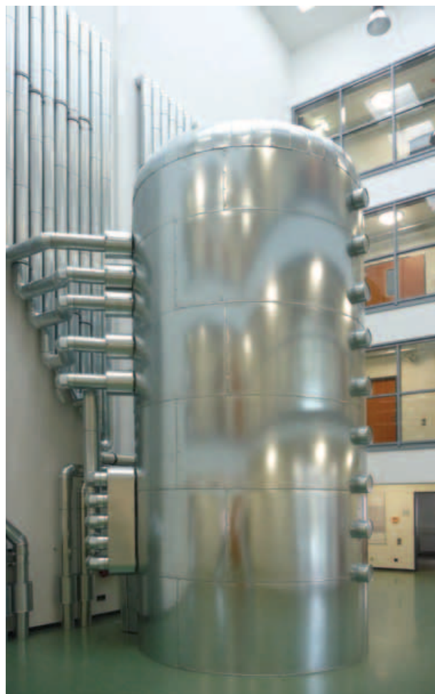
Ein 25 m 3 großer Schichtenspeicher für den Ausgleich zwischen Wärmeangebot und -bedarf befindet sich im Foyer des Gebäudes (Foto: LS Bauphysik und Gebäudetechnik)
