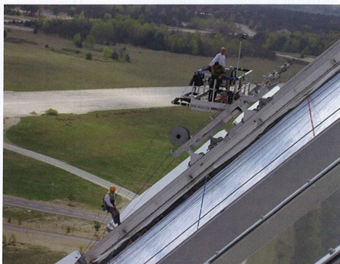
Bild 14. Befahranlagen Bild 14. Moveable scaffoldings
