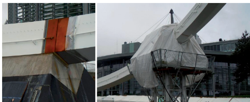
Bild 1. Montage auf der Baustelle und Einhausung der Schweißstelle, AKC in der Autostadt Wolfsburg
