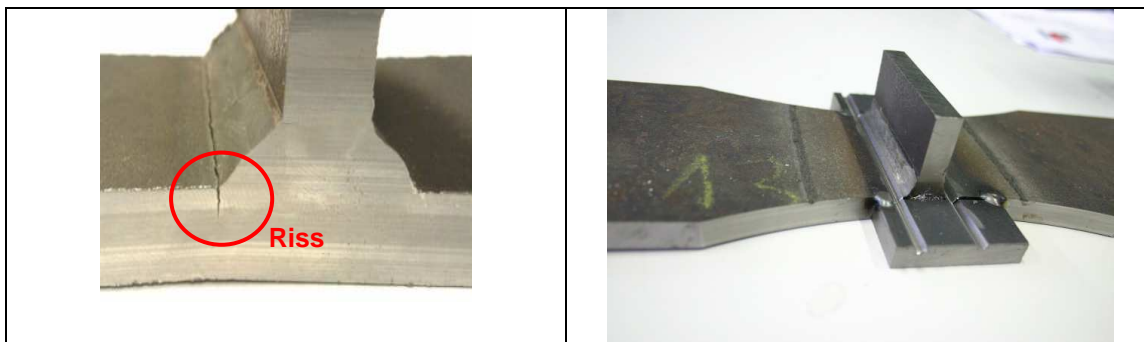
Abbildung 2: Vorhandener Riss (li.), Ausschleifen eines Risses (re.)
