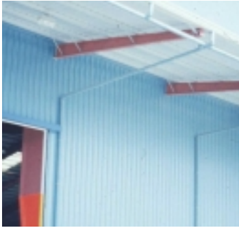
Bild 2 - Stabilisierung der Riegel durch Flanschstreben am Beispiel eines Hallenvordaches Figure 2 – Example for Stays at a steel hall canopy
