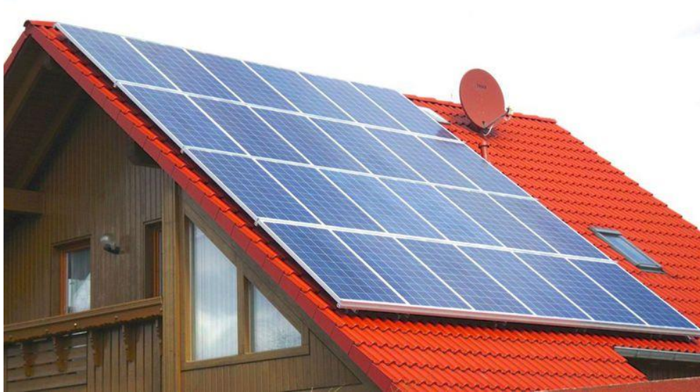
Bild 2: typische PV Dachanlage im Niederspannungsverteilstromnetz
