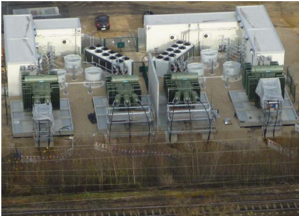
Bild 3: Umrückerwerk wie in Cottbus, nahe Bahnhof
