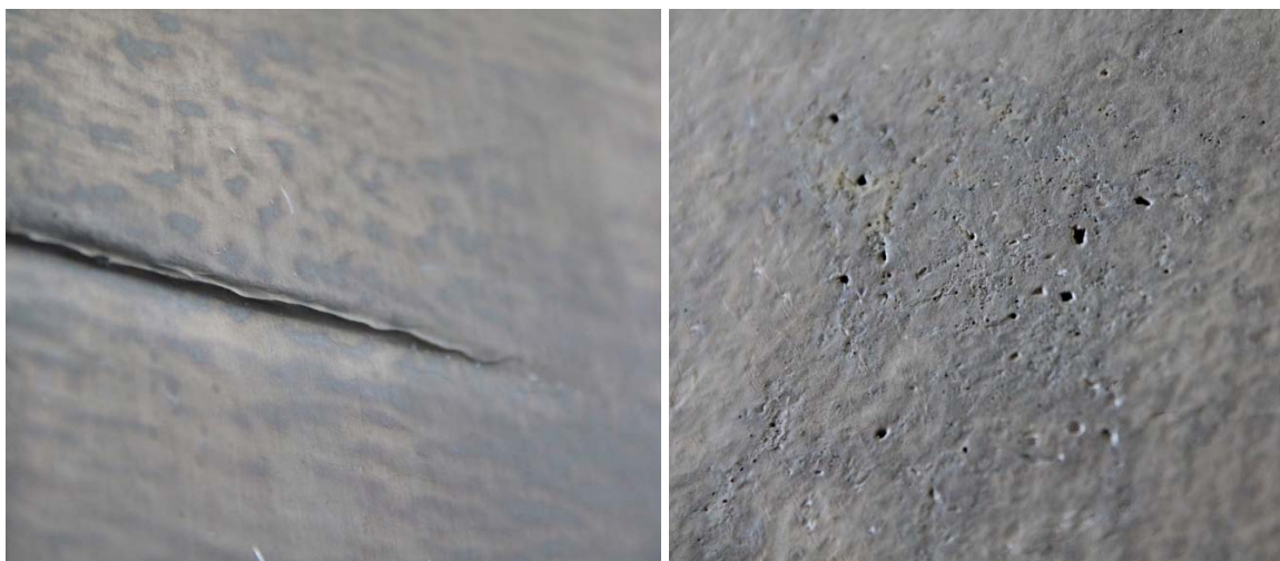
Abbildung 58: rissförmige Strukturen, links; löchrige Oberfläche, rechts
