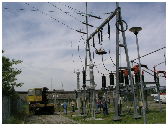
Optische Wandler im Umspannwerk der Enea
