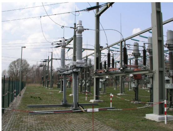
Optische Wandler im Umspannwerk der enviaM
