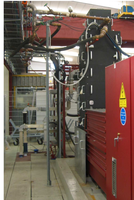
Klystron mit angeflanschem Hochspannungstransformator [Quelle: DESY]
