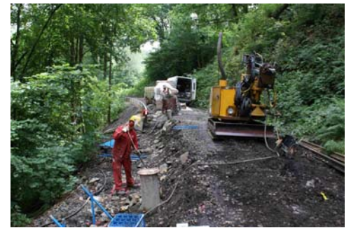
↑ Vom Sicherung der verwitterten übersteilen Felsböschung mit Ankern, hinten Sicherung der hohen Schotterbettung des Gleises mit Schotterhalteplatten
