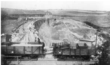
↑ Zwei aufgebockte regelspurige Güterwagen werden im langen Anschlussgleis unmittelbar vor der Baustelle der Sperrmauerkrone entladen (1913).
