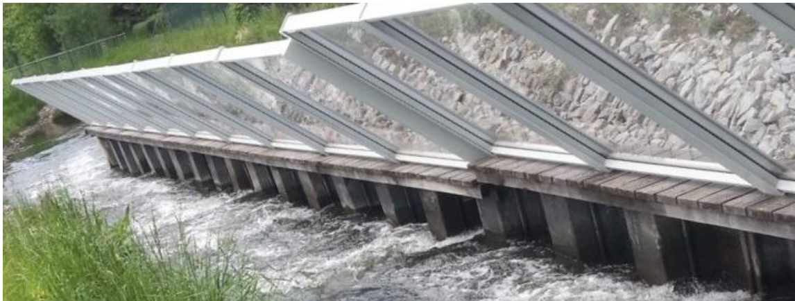
Abbildung 1: Genaigte Schallschutzwand an Fischaufstiegsanlage
