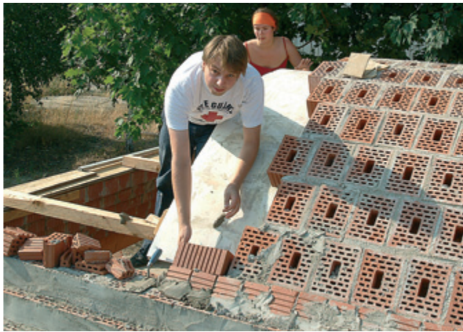
Alexandra Sohn und Jacob Lorenz beim Bau einer gewölbten Stahlbetondecke im Sommer auf dem BTU Campus
