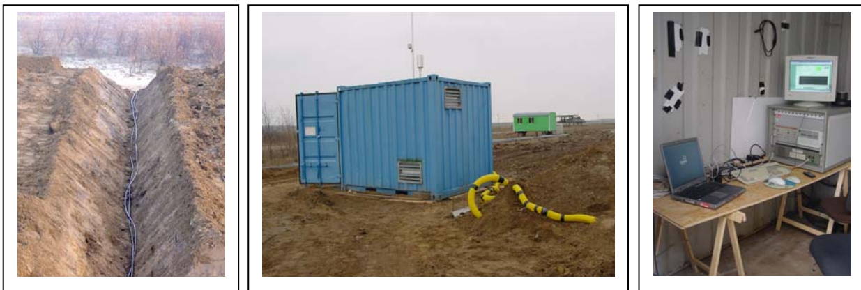
Abb. 190 : Sensorkabelführung zum Messcontainer; Steuer- und Rechneinheit (re.)
