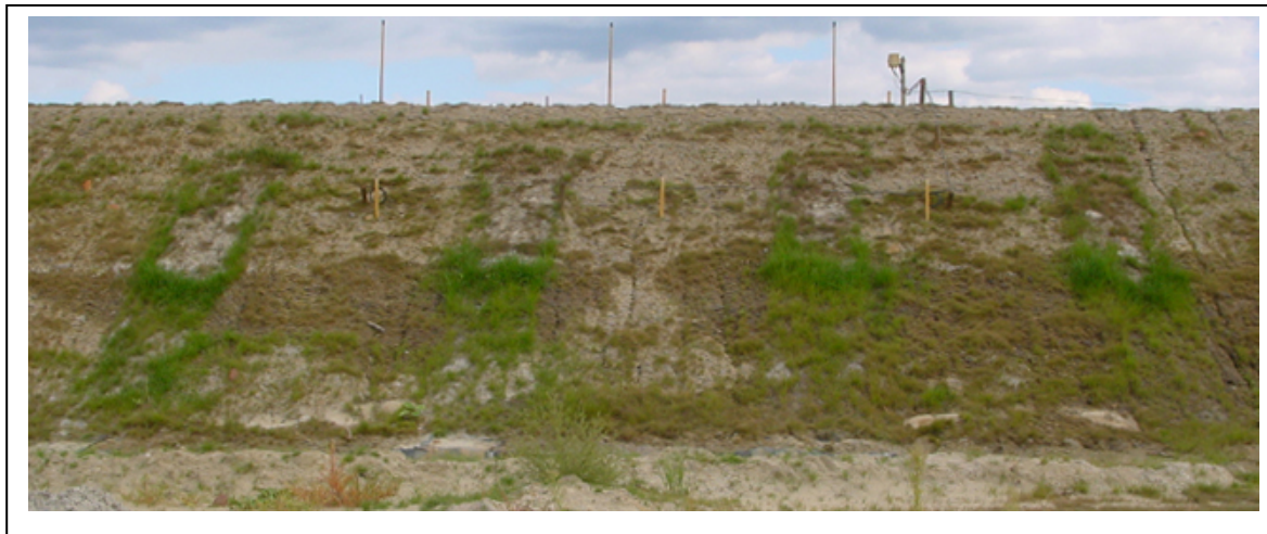
Abb. 243 : Fortschreitende Vernässung des Untersuchungsabschnitts mit Oberflächendichtung nach 23 Tagen Volleinstau
