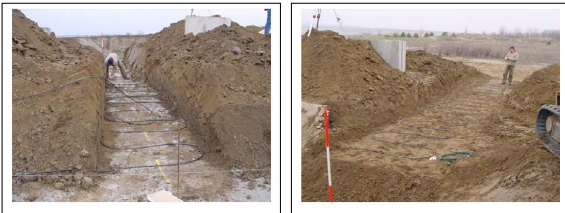
Abb. 188 : Verlegtes GESO-Temperatursensorkabel unterhalb der Überlaufstrecke Var. 3.1
