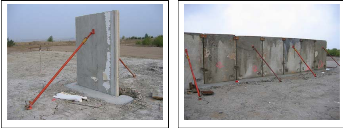
Abb. 127 : Gestelltes und gesichertes RC-Bauteil der Überströmstrecke und fertig ausbetonierter Teil der Innendichtung
