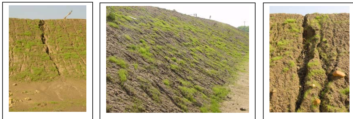
Abb. 155 : Erosionserscheinungen an den Böschungen des Versuchsdeichkörpers
