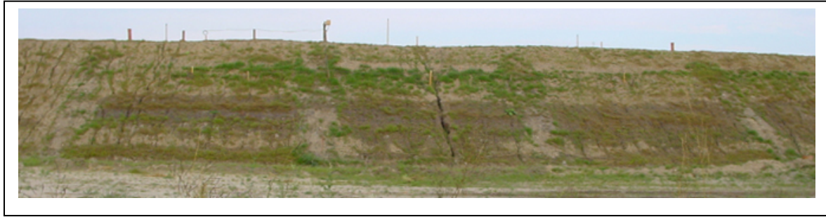
Abb. 246 : Fortschreitende Vernässung des Untersuchungsabschnitts mit Innendichtung nach 23 Tagen Volleinstau
