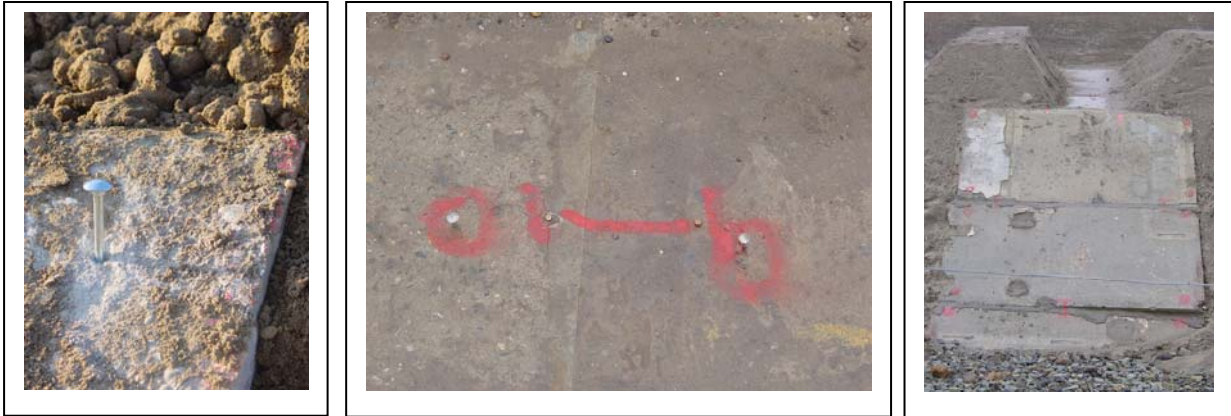
Abb. 174 : Setzungsmesspunkte der RC-Bauteile der Überlaufstrecken
