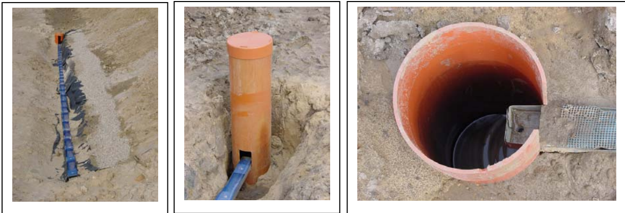
Abb. 191 : Abflussrinne und Sammler zur Durchflussmessung
