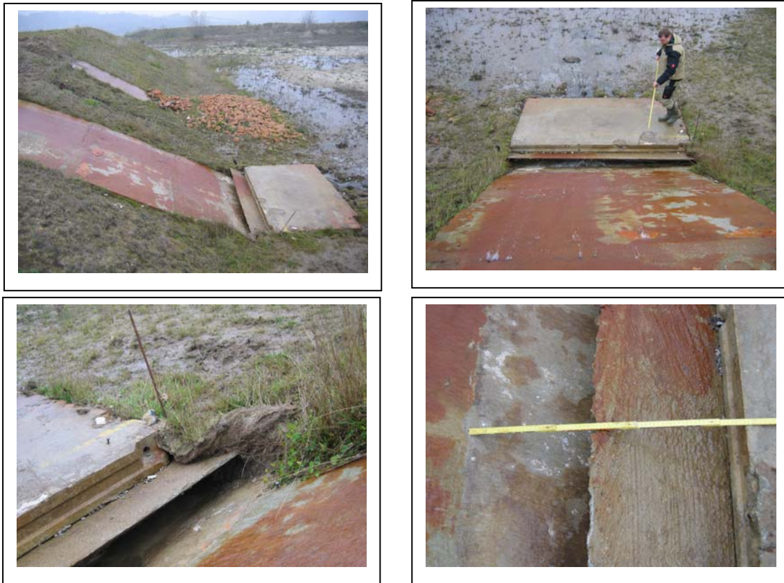
Abb. 303 : Zerstörter Tosbereich am landseitigen Böschungsfuß nach Überströmung der Überlaufstrecke Var. 3.1 mit 40 cm Überstau
