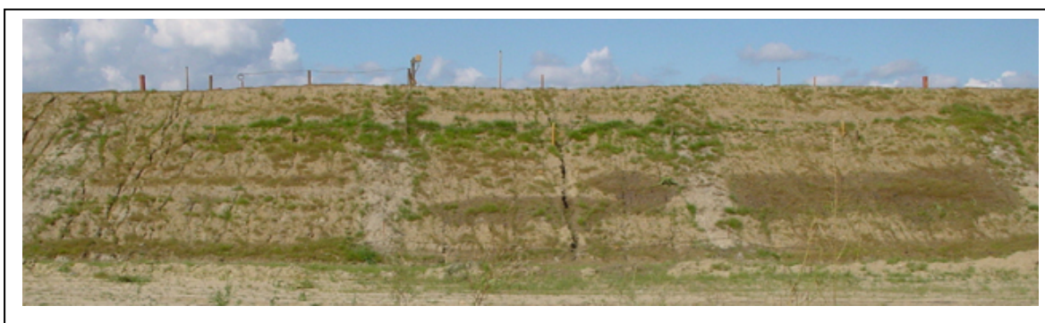
Abb. 245 : Beginnende Vernässung des Untersuchungsabschnitts mit Innendichtung nach 10 Tagen Volleinstau
