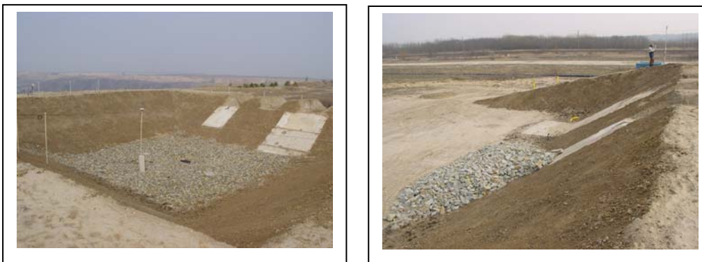
Abb. 156 : Nachsaat und Beseitigung von Erosionsrinnen auf der Deichoberfläche
