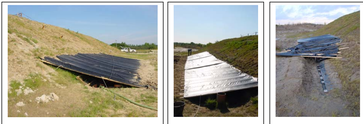
Abb. 193 : Abdeckung der Abflussrinne zur Durchflussmessung
