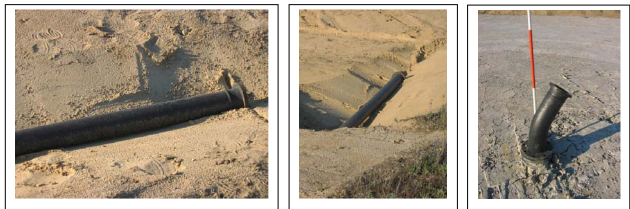
Abb. 121 : Rohrleitungsenden zur Befüllung und Entleerung
