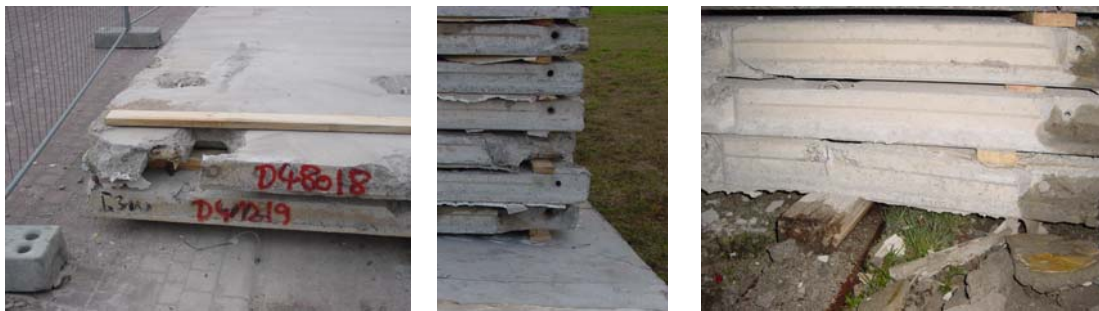
Abb. 95 : Anordnung der Stapelhölzer bei Deckenplattenstapeln (li., mi.); Bauteilbruch durch unsachgemäße Anordnung der Stapelhölzer (re.)
